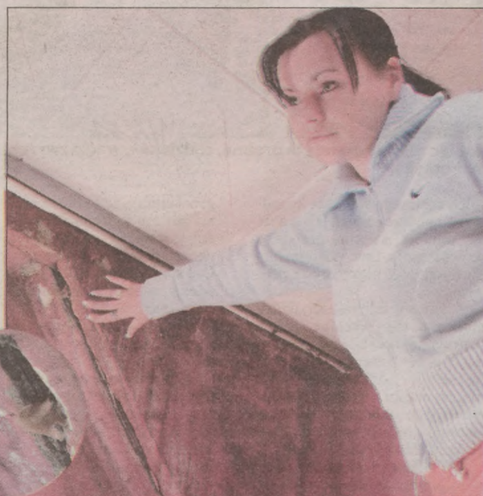
Katarzyna Szymańska przy pękniętym stropie. Obok grzyb.
