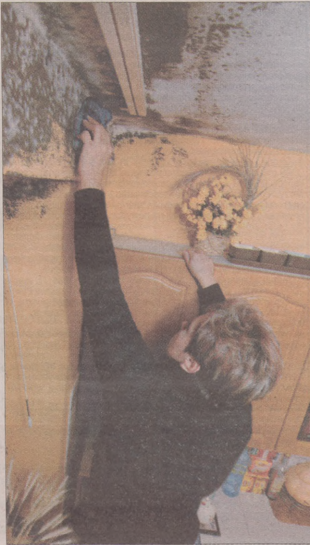
Pani Małgorzata przy zawilgoconej ścianie w kuchni.
