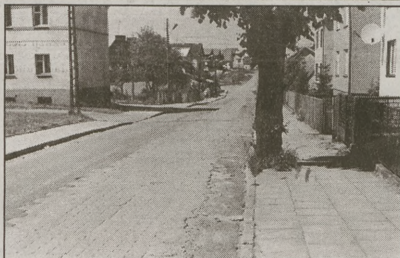
Najbardziej zaniedbanymi ulicami są drogi wewnątrzsielowe, jak np. ulica Podlaska w Miastku – nierówna i z ubytkami nawierzchni.
