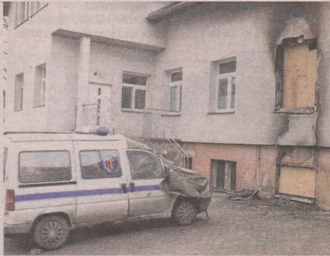
To jest zniszczone okno w sali nr 6, w której wybuchł pożar. Gdyby w porę dostrzeżono pożar, ofiar mogłoby być mniej
