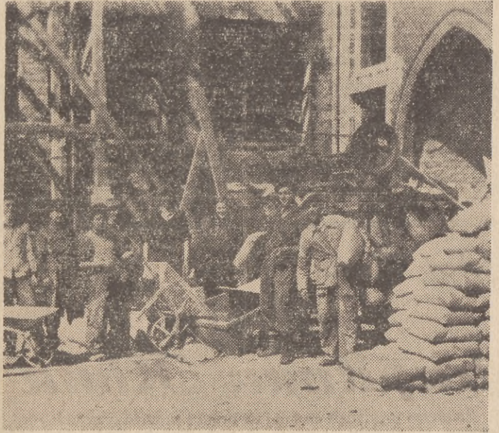
Brygada betoniarzka Bolesława Siemiona produkuje przy budowie nowoczesnej kliniki ortopedii i chirurgii dziecięcej w Gdańsku. Na zdjęciu od lewej: Bernard Glinkowski, Benedykt Ciesielski, Henryk Kwiatkowski, Stanisław Lewandowski, Benedykt Szubert, Bronisława Kowalska, Brunon Kowalski, Lucjan Tyla i Bolesław Siemion (mel)
