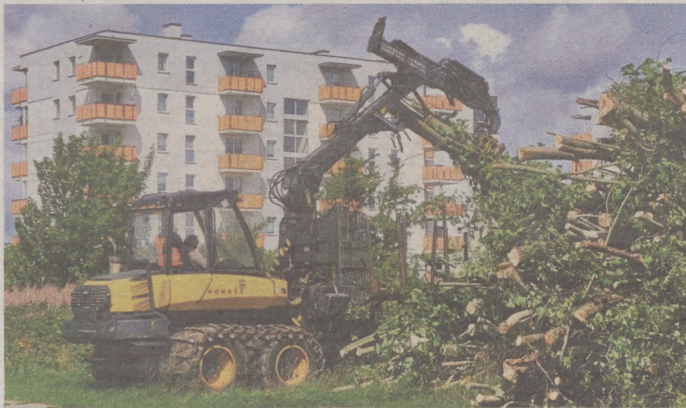
Przygotowanie terenu pod budowę zbiornika retencyjnego u zbiegu ulic Zaborowskiej i Legionów Polskich
