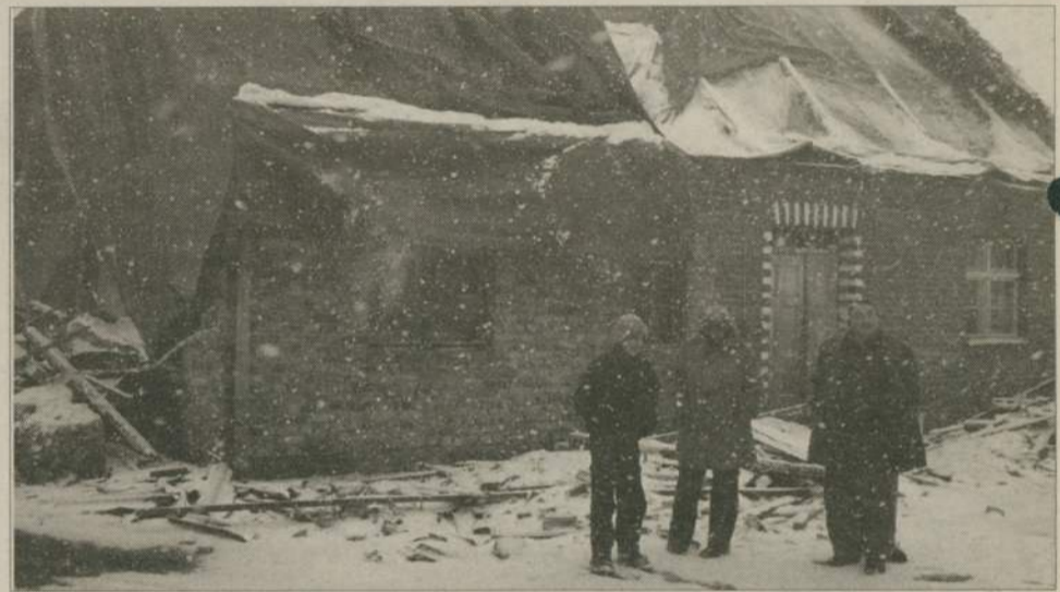
Pogorzelnicy nie mogą wejść do swojego domu, by sprawdzić co ocalało. Dach może się zawalić.
