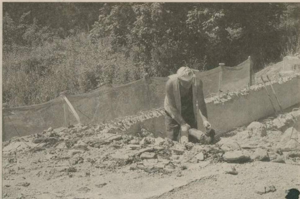
Za kilka dni oddana zostanie oficjalnie do użytku m.in. droga z Rzeczenicy do Przechlewa. Na zdjęciu: most na Dolince został dodatkowo wzmocniony, aby bez problemu mogły przez niego przejeżdżać samochody ciężarowe.
