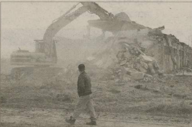
Jeszcze kilka chwil i ze zdevastowanych pomieszczeń gospodarczych po byłym pegeerze nie zostanie nawet ślad.
