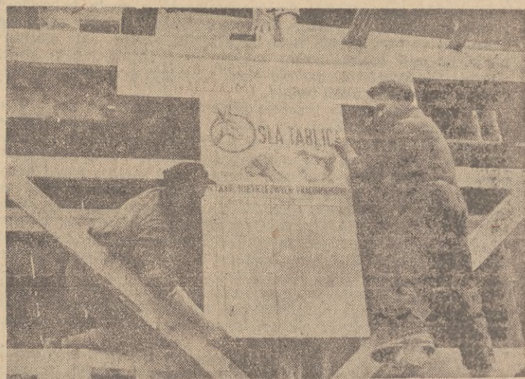
Robotnicy budowlani, pracujący przy odbudowie Gdańska, wypowiedzieli walkę bumelantryzmowi i pijaństwu. Na budowie budynku ZOR Nr 78 przy ul. Długiej zawieszono „osią tablicę”, na której umieszczone będą nazwiska pracowników, którzy stawią się do pracy w stanie nietrzeźwym, lub z tego powodu opuszczą dzień roboczy.
