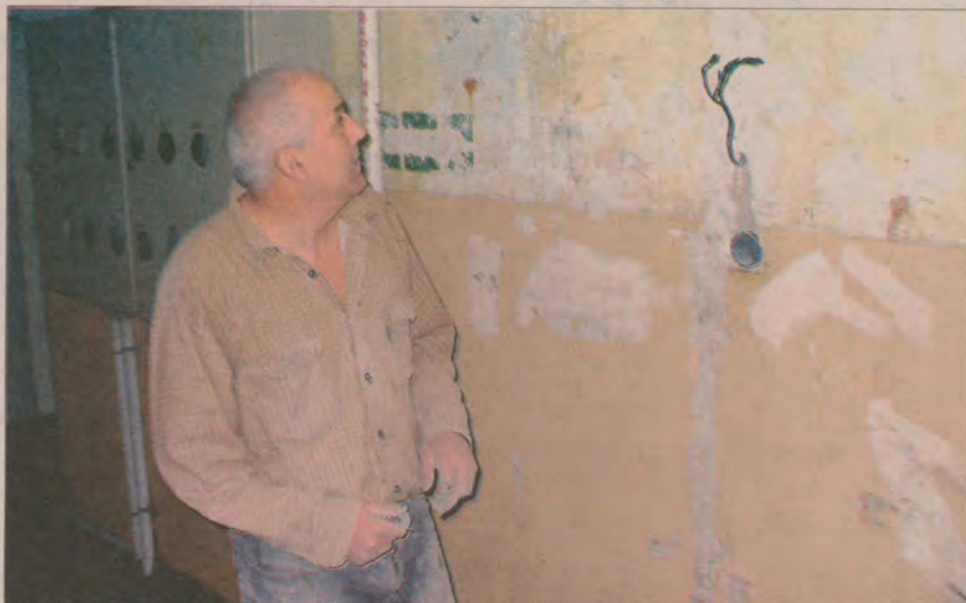
Zaizolowałem wystające ze ściany przewody, a następnego dnia, tuż przy drzwiach, znalazłem wyrwane kable - pokazuje Mirosław Krygier.
