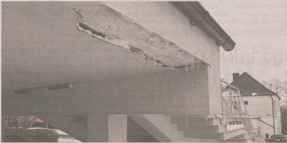
Tak wygląda teraz strop tarasu w Emceku
