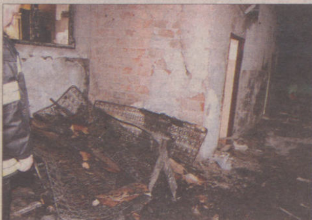
Zniszczone wnętrze schroniska dla nieletnich w Świdnicy.
