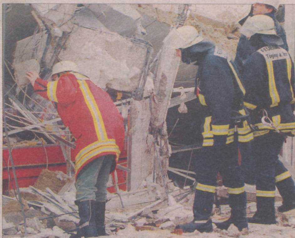
Pracownicy niemieckich służb ratunkowych sprawdzają supermarket w Toeing, gdzie wczoraj załamał się dach. Pracownicy i klienci sklepu, którzy znajdowali się w środku, zdążyli uciec, nikt nie został ranny.
