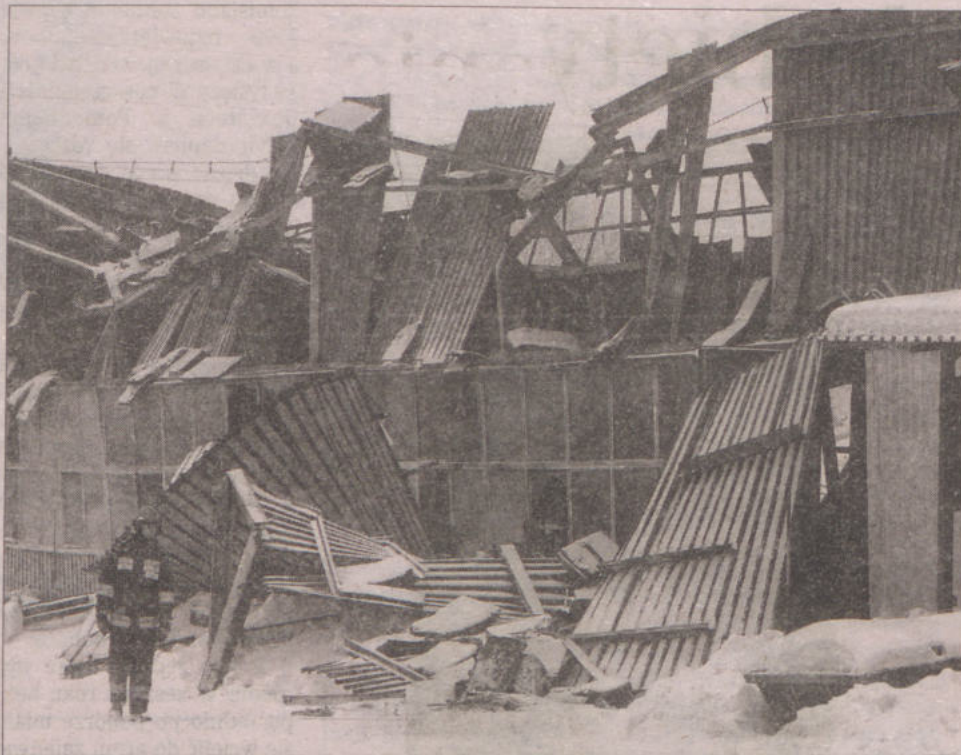
W Zabrzu zawaliła się opuszczona hala fabryczna. Strażacy przeszukali ruiny. Na szczęście nikogo nie było w środku.
