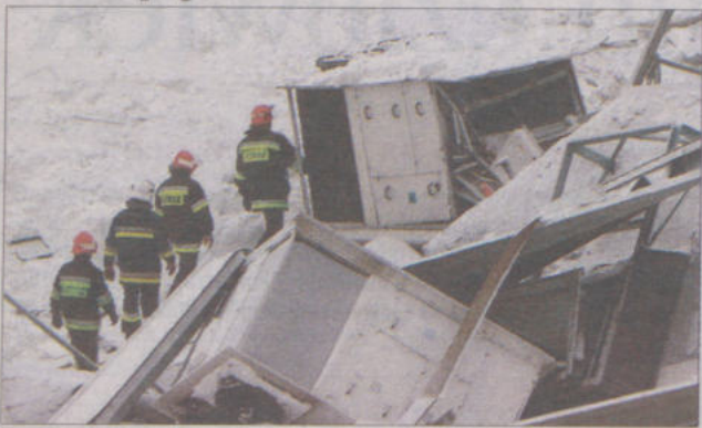
Konstrukcja hali była naruszona już kilka lat wcześniej.
