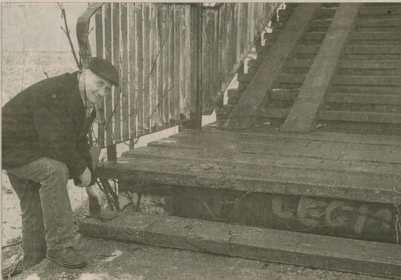
Tomasz Hofman, sołtys Radunicy, przy nieremontowanej od lat kładce.
