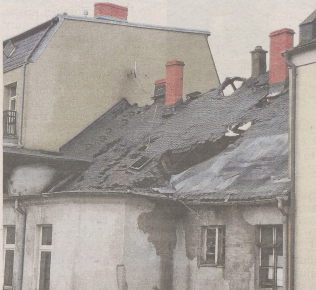
Kamienica przy ul. Tuwima po pożarze nie nadaje się do zamieszkania (widok dachu od strony podwórza)
