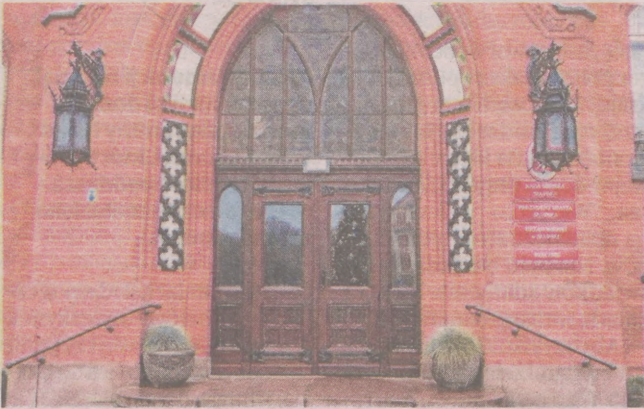
Drzwi wejściowe do słupskiego ratusza po renowacji. „Dzieło” graficiarza udało się usunąć
