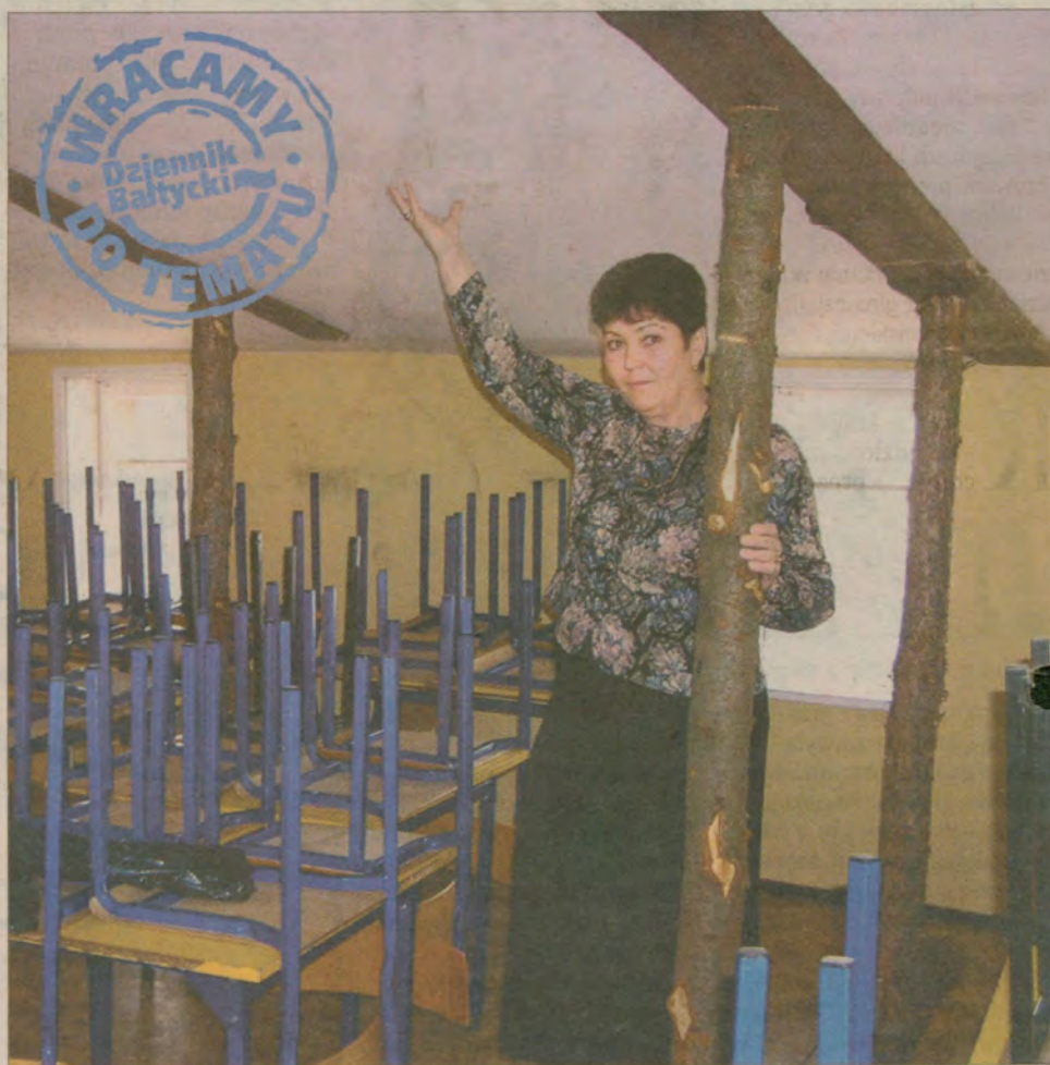
- Zapadające się poddasze Szkoły Podstawowej w Trzepowie wciąż czeka na remont - pokazuje dyrektor placówki Małgorzata Elwart.
