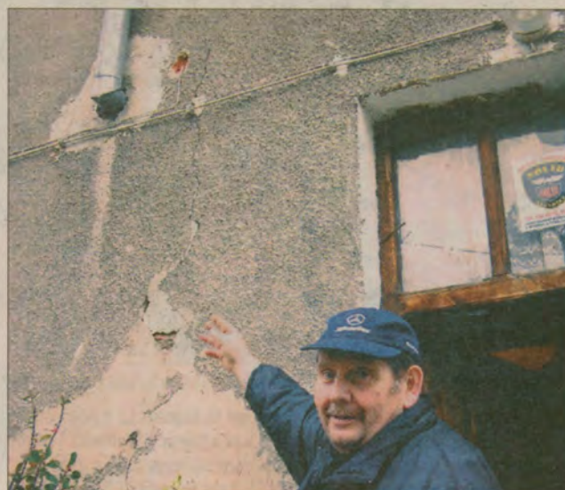
Roman Jakubiec, lokator domu przy ul. Starogardzkiej w Straszynie, pokazuje popękane ściany budynku.
