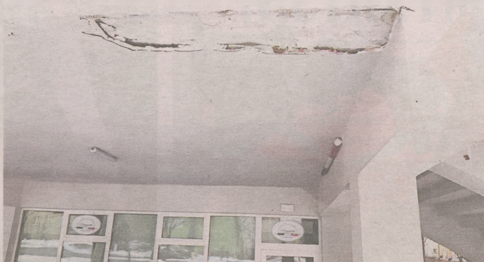
Jedna z niedoróbek stropu tarasu Młodzieżowego Centrum Kultury - odpadające płyty tynku
