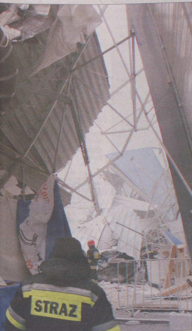
ch runął na kilkuset przebywających w środku ludzi. Praw- trzymała naporu śniegu. Polska norma dopuszcza nacisk etr kwadratowy dachu budynku.
