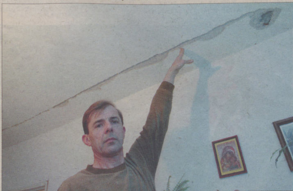
Popekane ściany i śruby wbijające się w sufit to problem, z którym państwo Zielińscy zmagają się od lat. Nowe mieszkanie nie powinno się tak szybko niszczyć - uważają.
