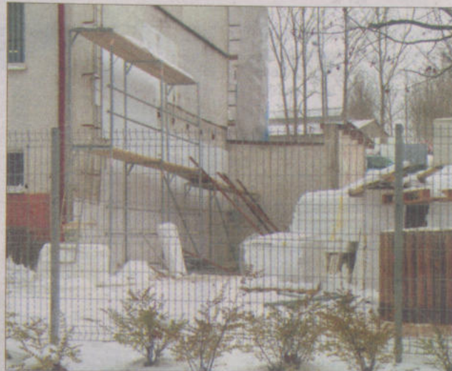
Materiały budowlane powinny być zabezpieczone przed wilgocią i mrozem.
