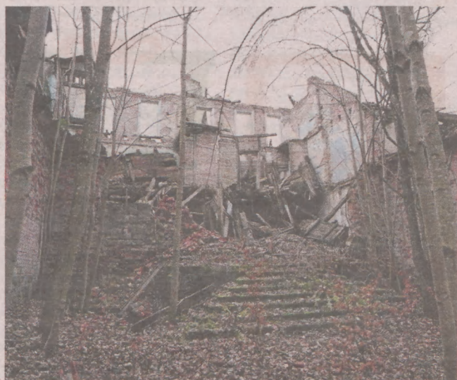
Pałac w Kamnicy to już ruina. Obiekt właściwie nadaje się tylko do rozbiórki
