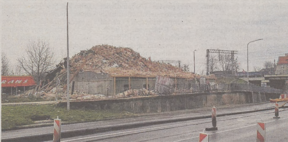
Po kamienicy przy ul. Tuwima pozostała tylko sterta gruzu
