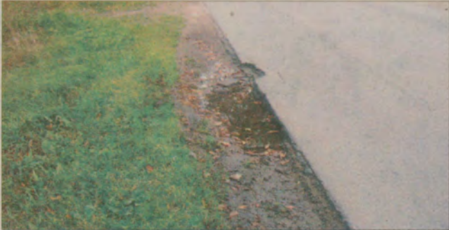
Koleiny na drogach są coraz głębsze, a asfalt coraz mocniej nadkruszony.
