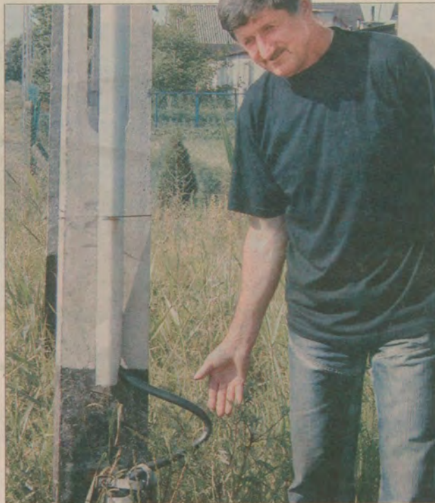
Marian Grudzień pokazuje uszkodzony przewód średniego napięcia przy ul. Wierzbowej w Przejazdowie.
