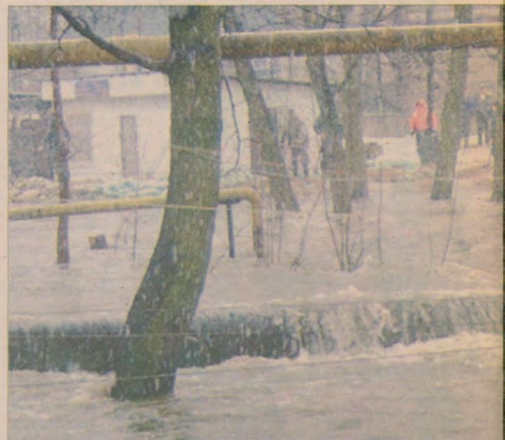
W Kolbudach wody Raduni przelewały się nad instalacją gazową, u
