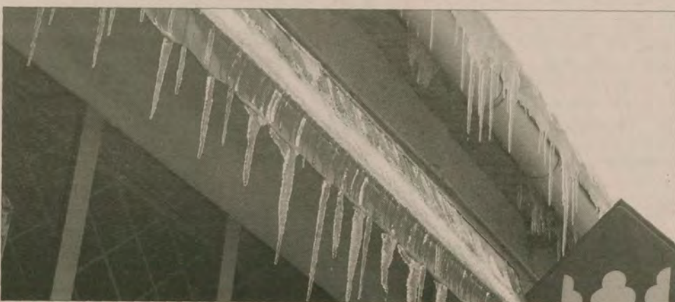
Potężne sople zwisają z dachów budynków przy ul. Wojska Polskiego w Pruszcze Gdańskim. Przechodniom radzimy ostrożność. Ciężki kawałek lodu może spaść na głowę i zrobić poważną krzywdę...
