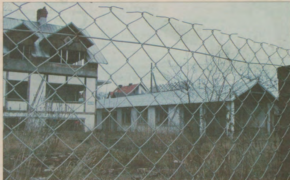
Budynek przy ul. Kościuszki w Pruszczu, potocznie nazywany Belwederem, straszy powybijanymi szybami i spalonym dachem.
