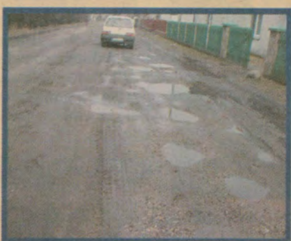
Przeznaczenie zaledwie jednego procenta gminnego budżetu na drogi, nie daje nadziei na poprawę ich stanu.
