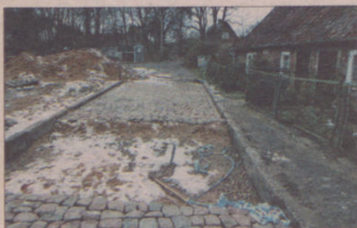
Ulica Kwietna w Gdańsku. Miała być lepsza niż przed remontem.
