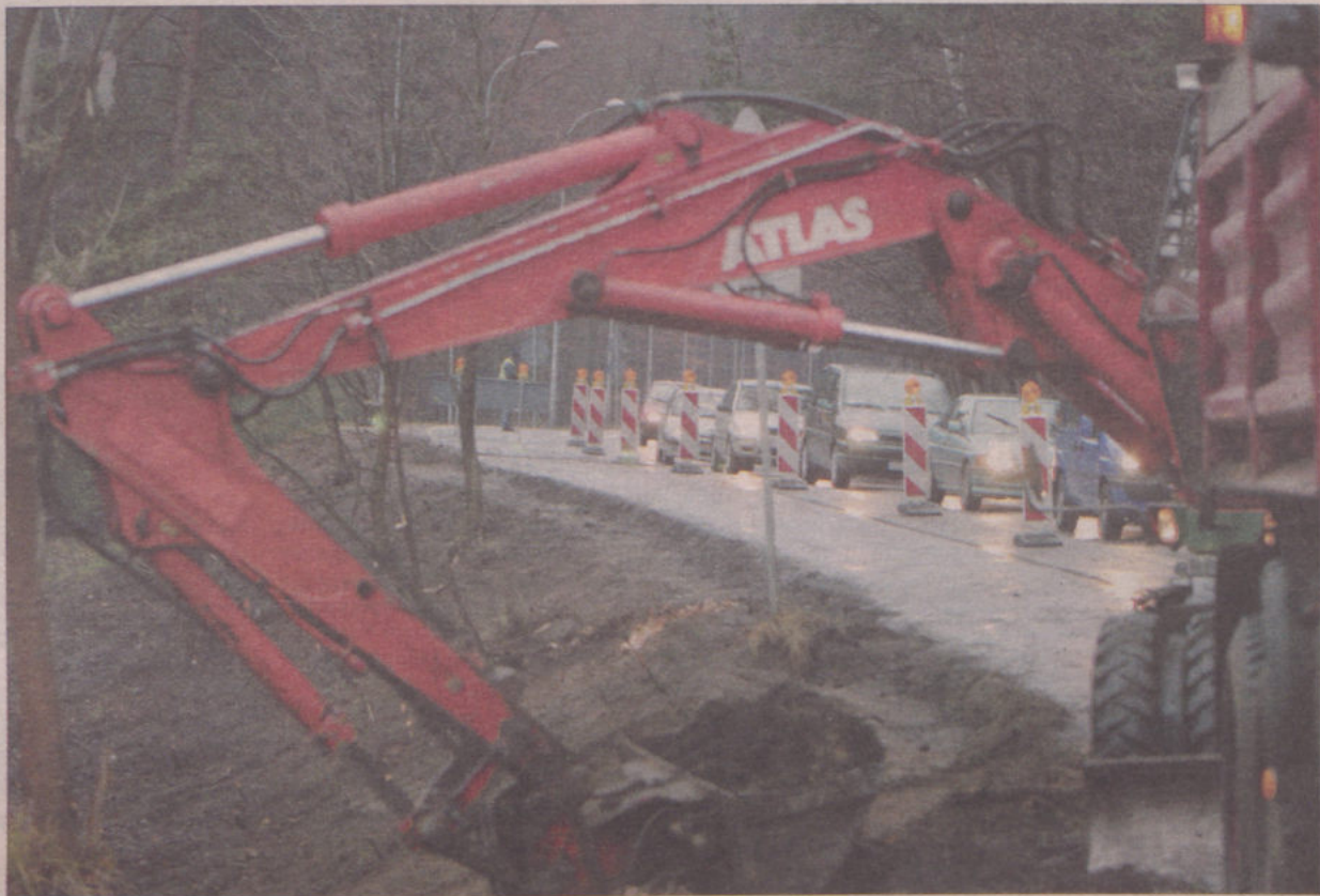
Wprowadzenie ruchu wahadłowego na Spacerowej przytkało ulicę. Skutki zwężenia jezdni odczuwali też kierowcy jadący ulicą Słowackiego, gdyż część kierowców chcąc zjechać do alei Grunwaldzkiej skorzystało z objazdu.
