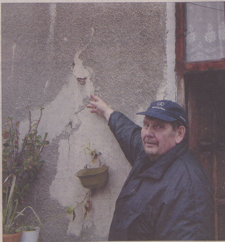
- Nasz dom w każdej chwili może runąć - Roman Jakubiec pokazuje popękane ściany za-bytkowego budynku w Straszynie.
