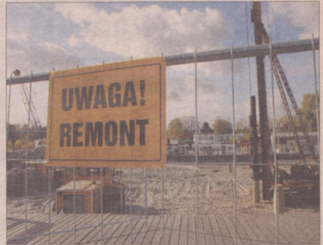
Choć moło przy wejściu jest rozebrane, nie zniechęca to spacerowiczów do wchodzenia na dalszą część pomostu.
