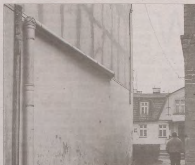
Lokatorzy domu przy ul. Grunwaldzkiej 14 w Pruszczu, od 5 lat spierają się o rury kanalizacyjne. RURA
