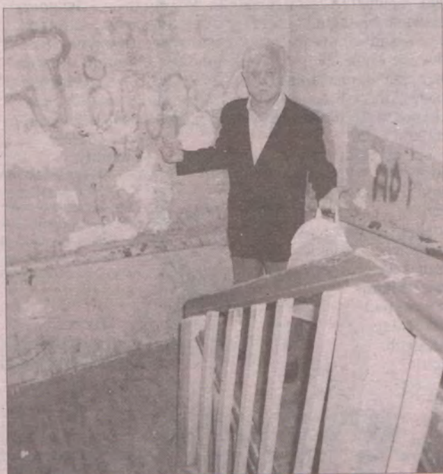
- Oto efekt zaniedbań - Marian Niewiadomski pokazuje zapuszczoną klatkę schodową budynku przy Placu Wyzwolenia w Pruszczu Gdańskim.
