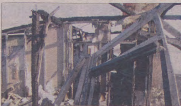
Jedną z przyczyn pożarów domów jest niebezpieczność przewodów kominowych, powstała podczas spalania sadzy.
