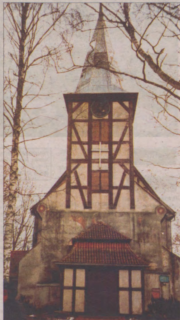
Blacha na wieży świątyni wymaga wymiany i uzupełnienia.
