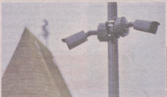
Kamery na Bulwarach nad Słupią zostały tak zainstalowane, żeby nie było punktów bez obserwacji
