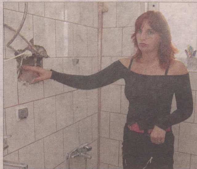
Magdalena Żuk pokazuje źle wykonane instalacje w łazience.
