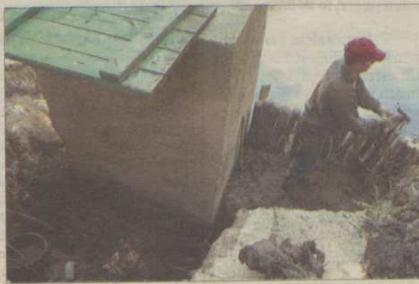
Woda ze stawu znalazła ujście ze zbiornika. Grozilo to osunięciem umieszczonej powyżej grobli.
