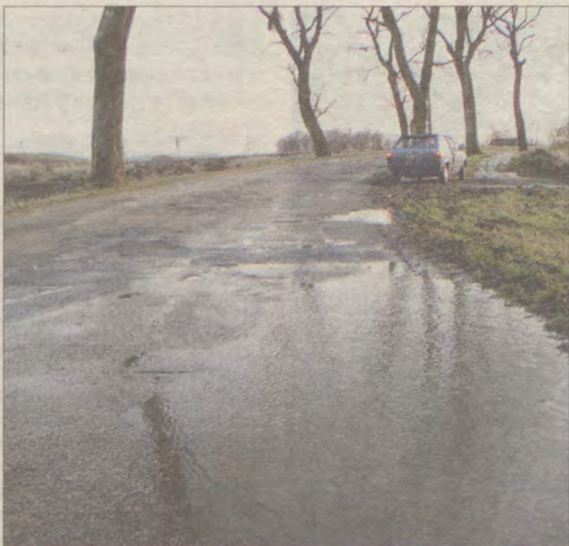
Droga wymaga natychmiastowej przebudowy.
