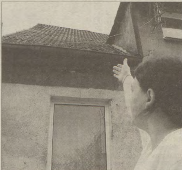
Wielu mieszkańców musi wymienić pokrycie dachowe. Na zdj. Anna Łodtka z Tczewa.
