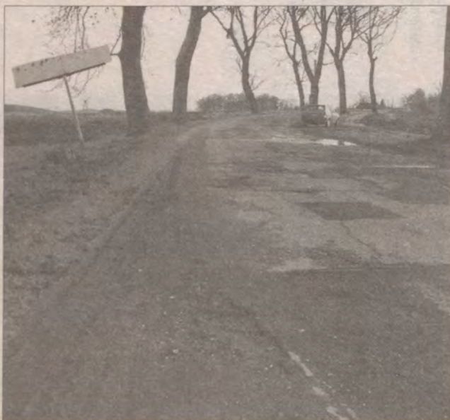
Droga ze Stanisławia do Lubiszewa wymaga remontu.
