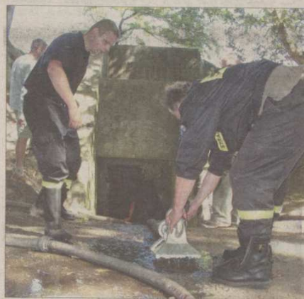
Po nad trzy godziny strażacy wypompowywali wodę z zabytkowego obiektu na Westerplatte. Podmywała Placówkę Fort przez 30 lat.
