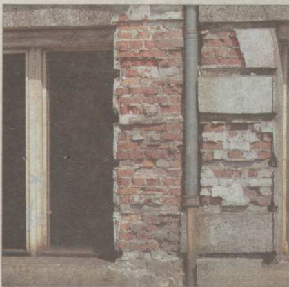
Tynk odpada płatami od fasady głównego budynku dworca. Wewnątrz jest jeszcze gorzej.
