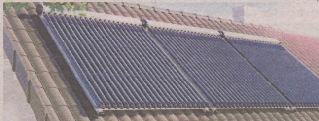
Kolektory słoneczne to darmowe ciepło do podgrzewania wody użytkowej i wsparcia ogrzewania budynku.
