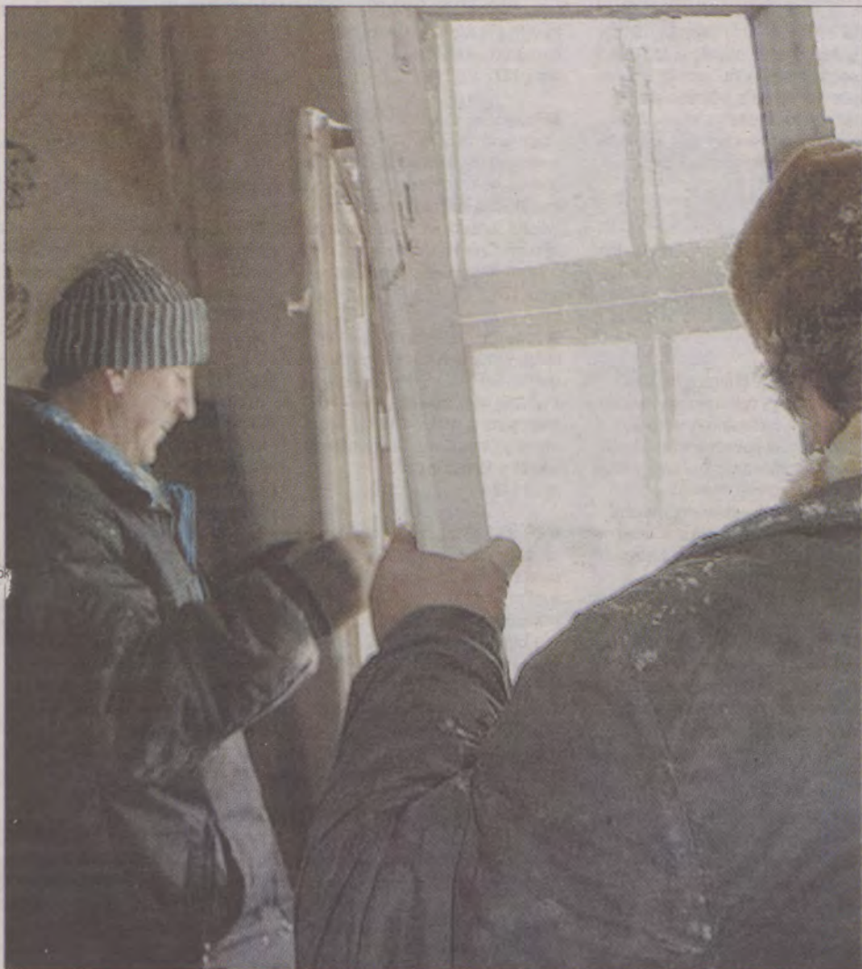
Uszczelnienie okien pozwoli przeżyć najcięższe mrozy.
