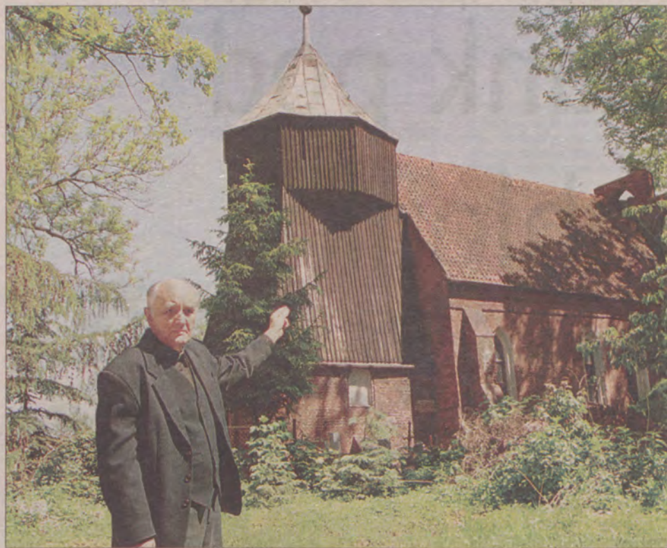
Ksiądz proboszcz Bogdan Pałubicki pokazuje jak zniszczony jest dach kościoła.
