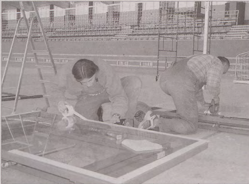
Czy po feriach w tej sali gimnastycznej będą odbywały się lekcje wychowania fizycznego? Urzędnicy chcą najpierw wymóc na wykonawcy usunięcie usterek. Fot. Aleksander Winter
